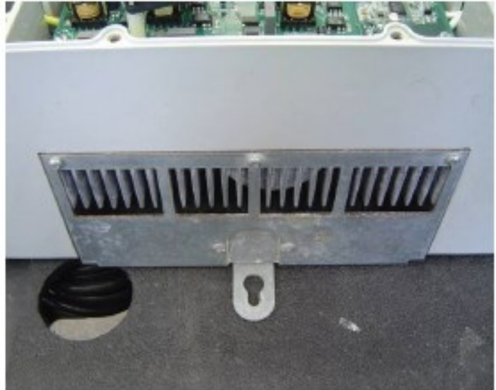
Imagem 3 Ferrugem de aresta em um componente galvanizado
